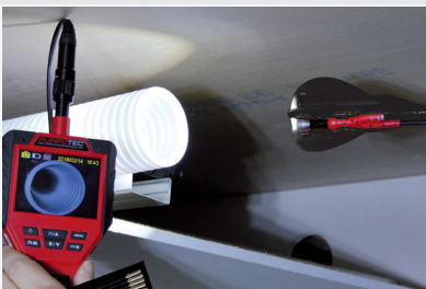
Lüftung- und Wartungsinspektion
